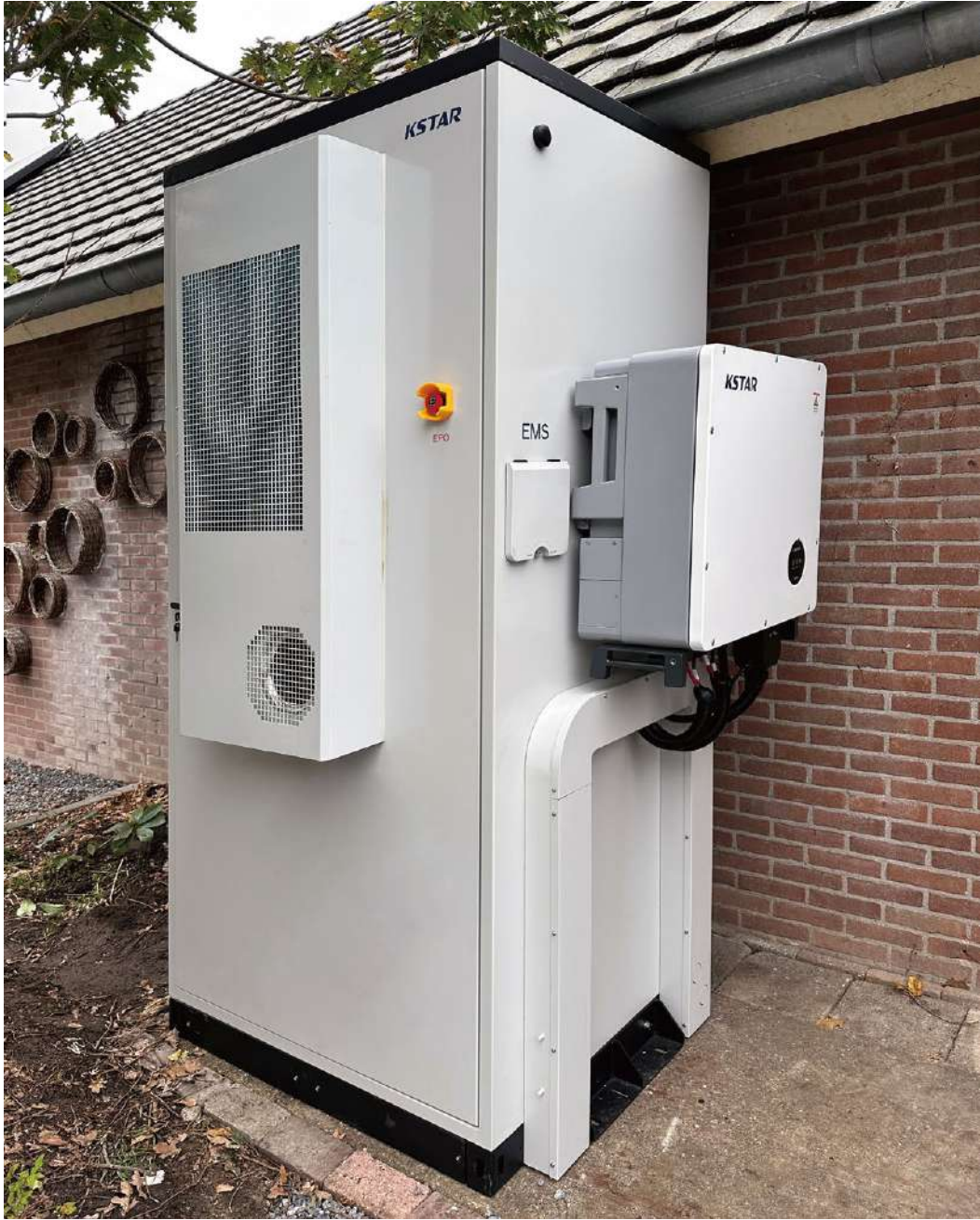
08 C&I ESS-project in Nederland
